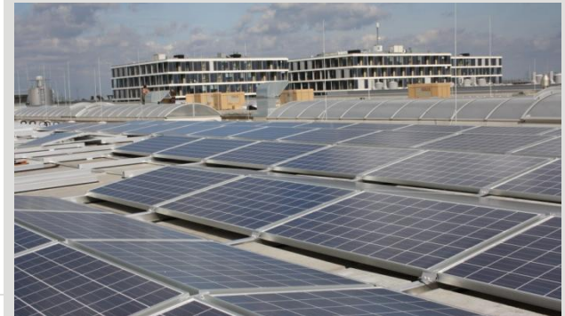
Flachdach-Anwendung, Thalheim, Deutschland
