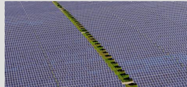
Solarpark Finsterwalde, Deutschland
