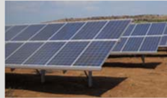
Solar power plant: Puglia, Italien
