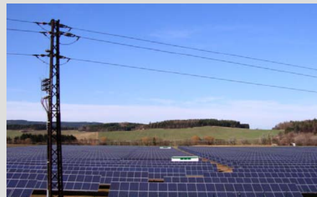
C&I system (greenfield): Příbram
